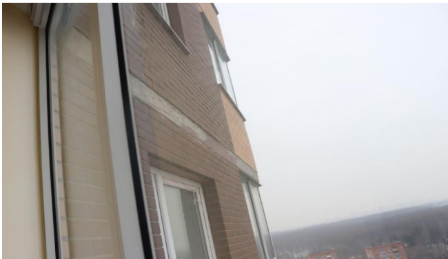
Рис.2 Локальные участки с штукатуркой и окрасочным слоем на торцах плит перекрытия
