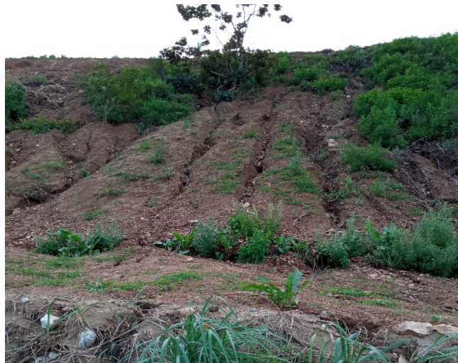
Рисунок 2. Последствия планировочных работ – струйчатая эрозия, возникшая при строительстве туристической базы на верхней поверхности морского мыса. Пос. Южно-Морской Приморского края
